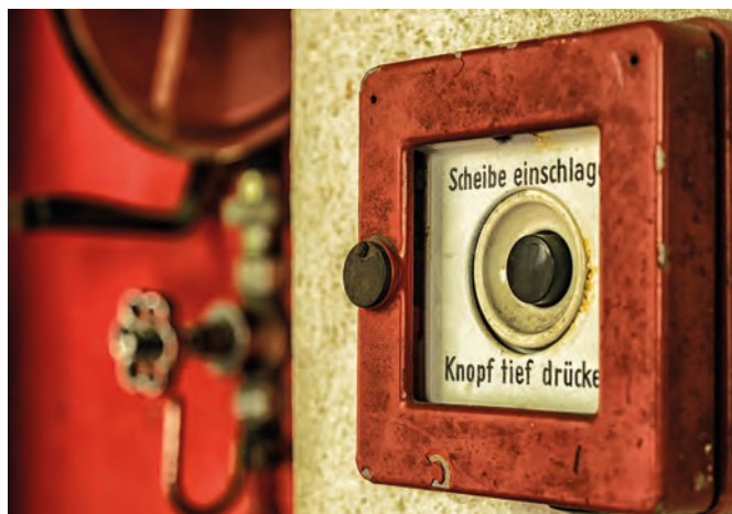
Zu den Brandschutzmaßnahmen gehört unter anderem das Anbringen von schnell erreichbaren Brandmeldeeinrichtungen.
